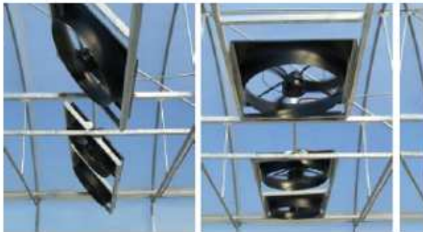
Lucht recirculatie systeem
