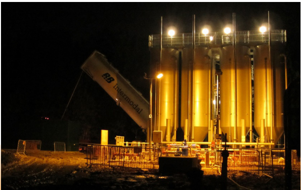
Kontinuierlicher Sandfilter zur Nitrifikation mit 300 \text{ m}^3 / \text{h} Kapazität
